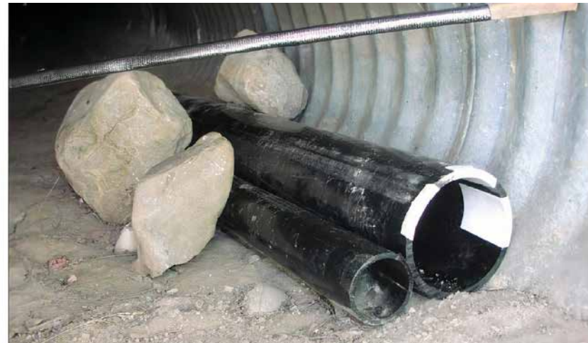
Figura 45: Tubos para proporcionar refugio a especies de tamaño pequeño, en una alcantarilla con dedicación exclusiva a paso de fauna de especies medianas. Fuente: Federal Highway Administration - U.S. Department of Transportation, 2011.
