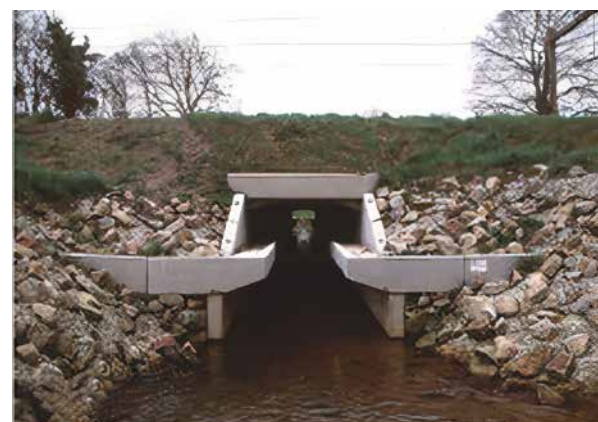
Figura 40: Box culvert con pasarelas a ambos lados. Fuente: Van der Grift & van der Sluis, Design of an ecological network for Piano di Navelli (Abruzzo), 2003.
