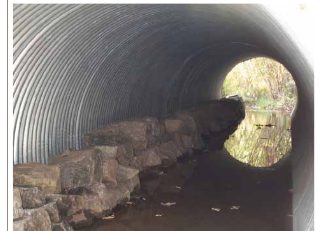
Figura 48: Hilera de piedras generar un paso seco en una alcantarilla con poco flujo de agua. Fuente: Federal Highway Administration - U.S. Department of Transportation, 2011.
